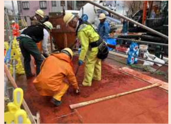
高熱伝導コンクリート打設状況 （意匠上、着色しています）
